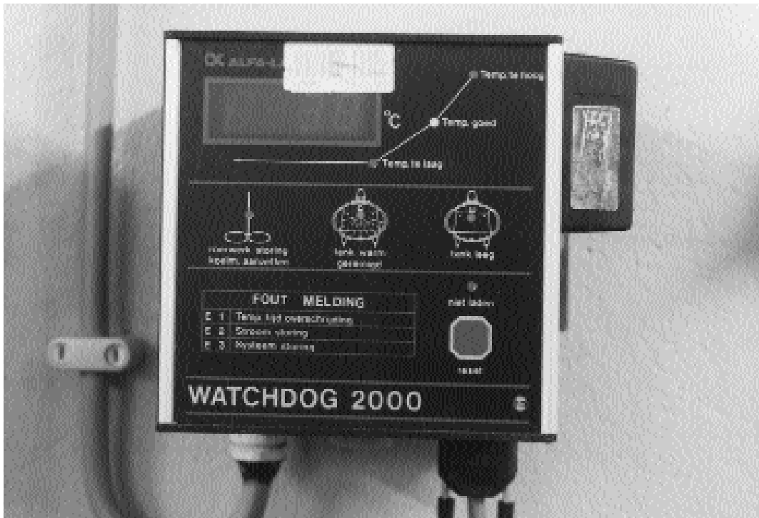
Met de melkwacht wordt het functioneren van de melkkoeltank bewaakt.
