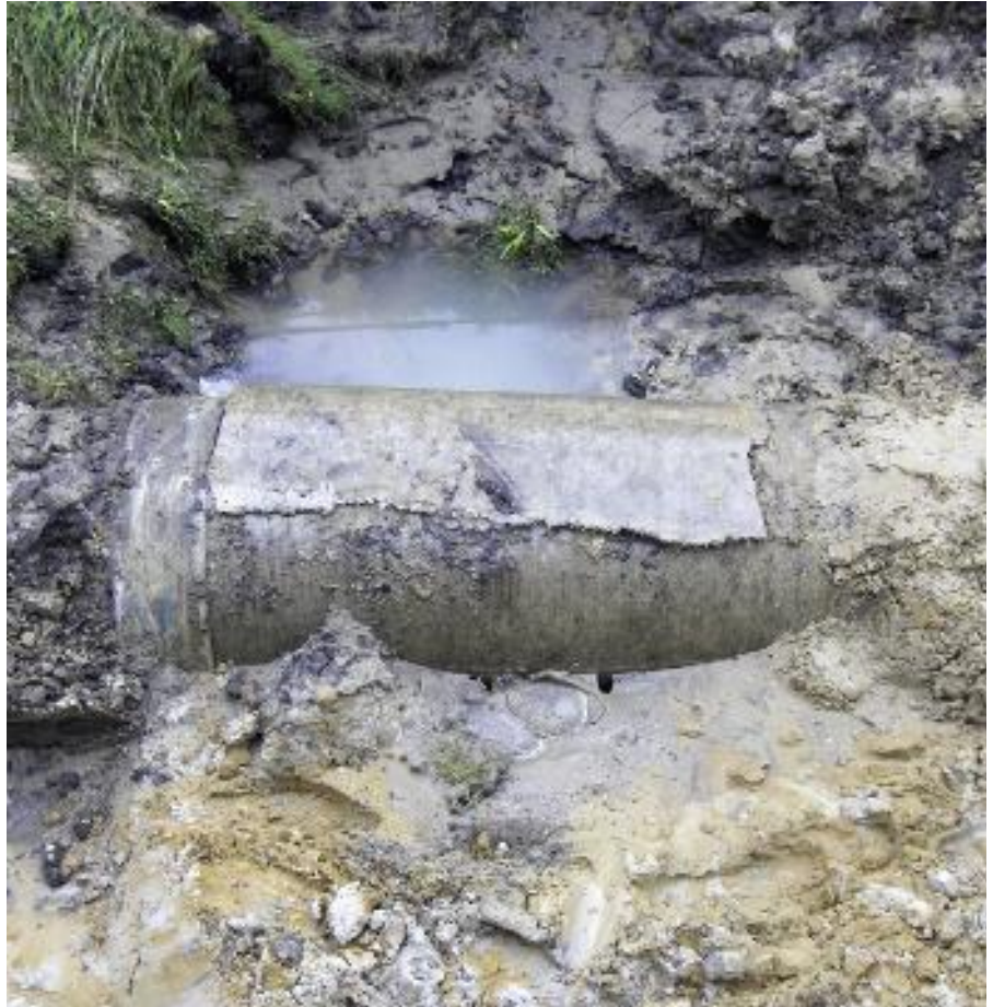
Een leidingbreuk levert overlast. Het geeft echter ook informatie over de conditie van het leidingnet.
