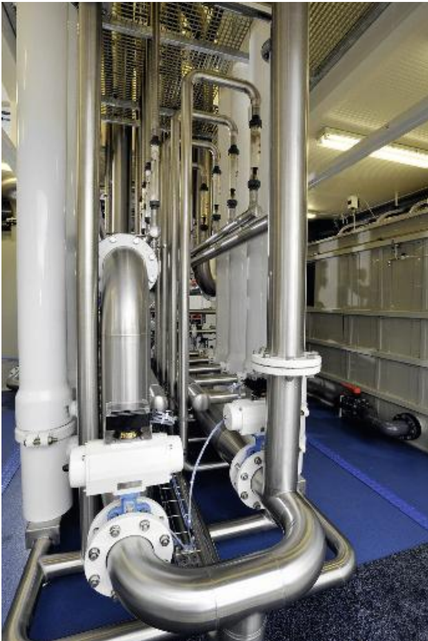
Eén van de zuiveringsinstallaties.
