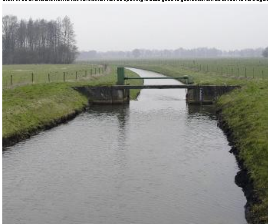
Stuw in de Drentsche Aa. Na het verkleinen van de opening is deze goed te gebruiken om de afvoer te vertragen.
