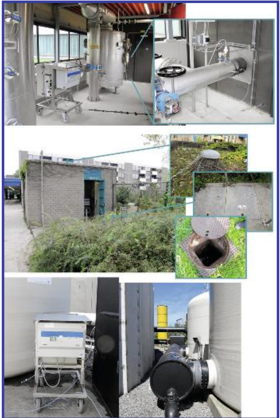
Een aantal meetlocaties, van boven naar beneden: ozonisatie op drinkwaterproductiebedrijf Weesperkarspel, rioolgemaal van een bestaand gescheiden rioolstelsel en de afzuiging van aerietank 2 op rwzi Amsterdam-West.
