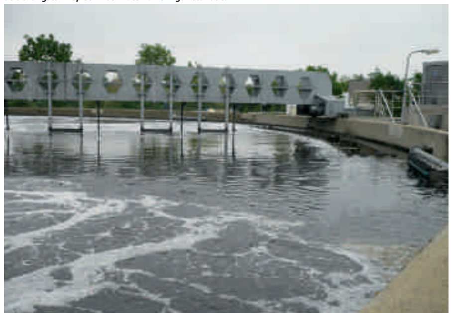
Beluchtingstank op een rioolwaterzuiveringsinstallatie.
