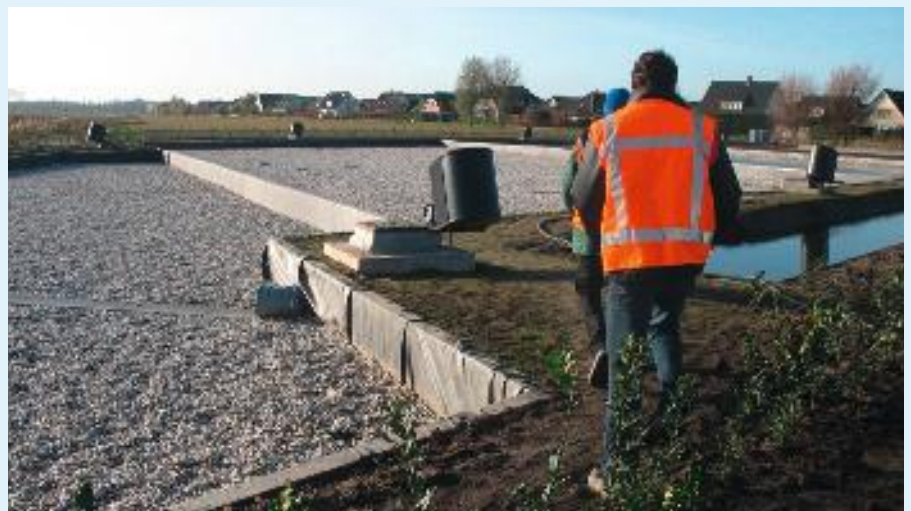
De langzame zandfilters met ijzerkrullen en kalk bij de Blaricummeermeent.
