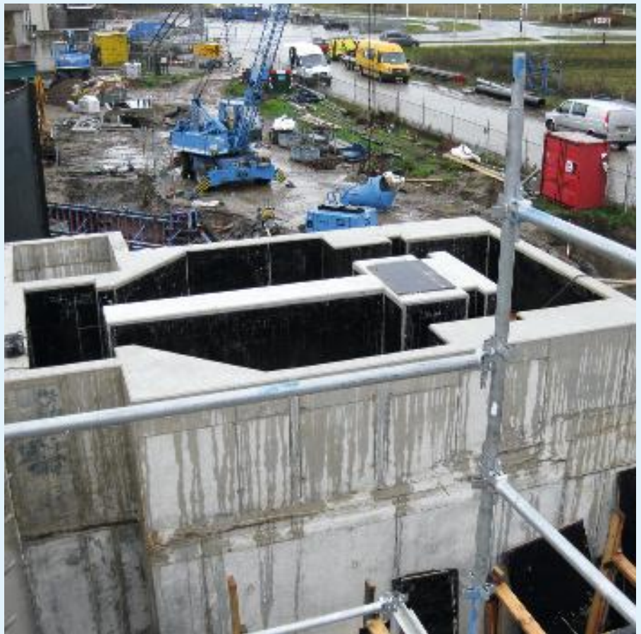
Het ontvangwerk voor de perforatieroosters.
