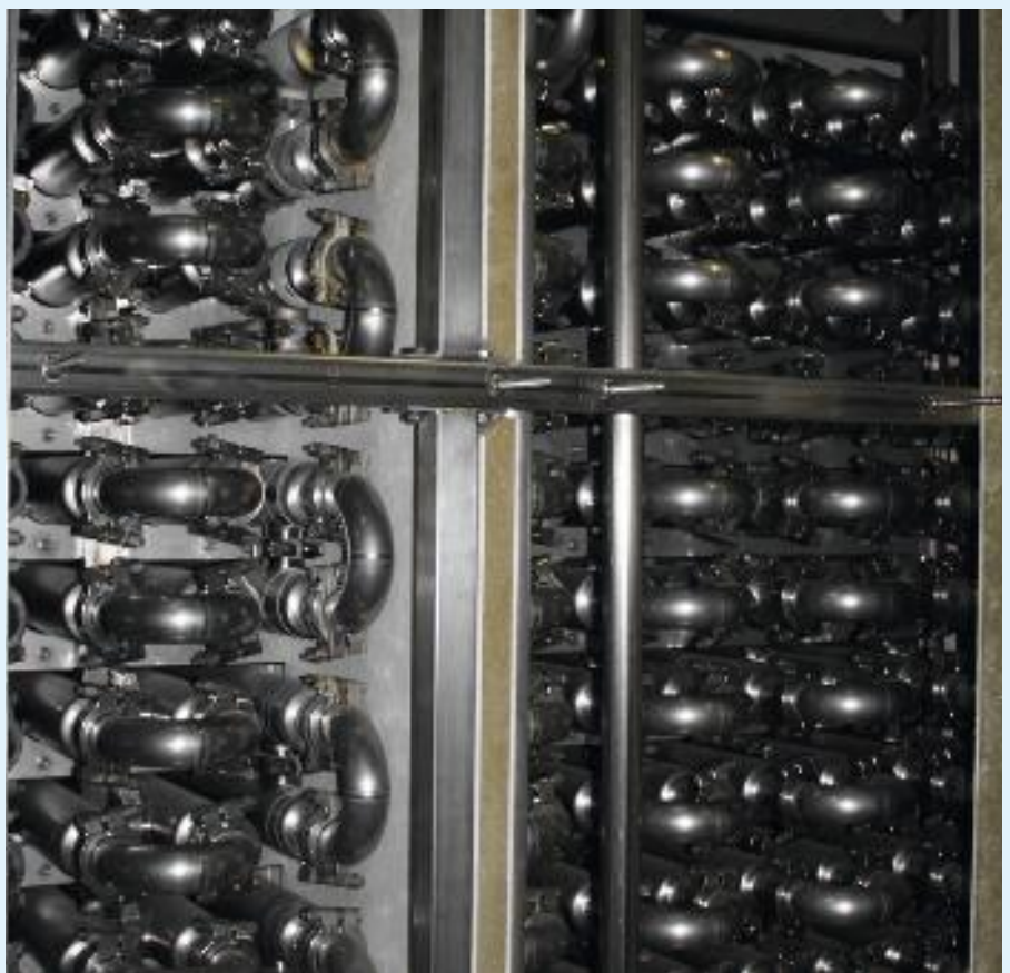
Interne warmtewisselaars van de Lysotherm-installatie op de rwzi Lingen.
