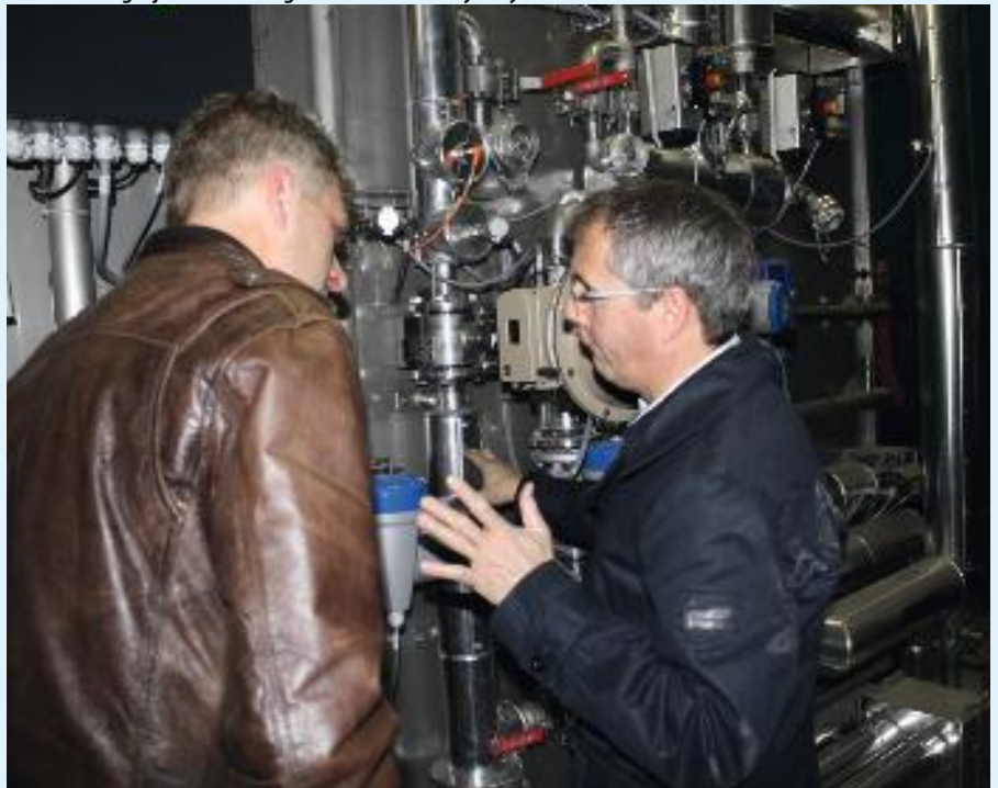
Tekst en uitleg bij de kleinschalige thermische drukhydrolyse-installatie.
