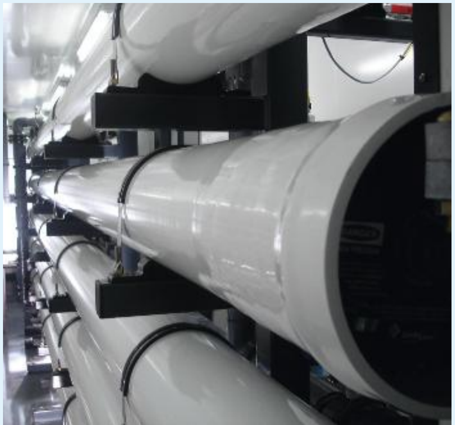
RO-proefinstallatie van Noardburgum in een zeecontainer.
