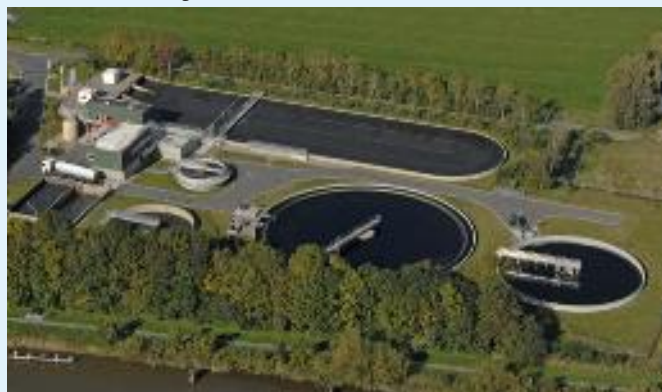
De rioolwaterzuiveringsinstallatie van Burdaard.
