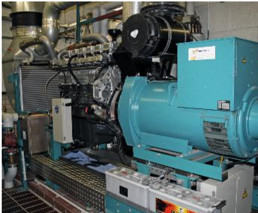
De warmtekrachtkoppelinginstallatie in Kampen.
