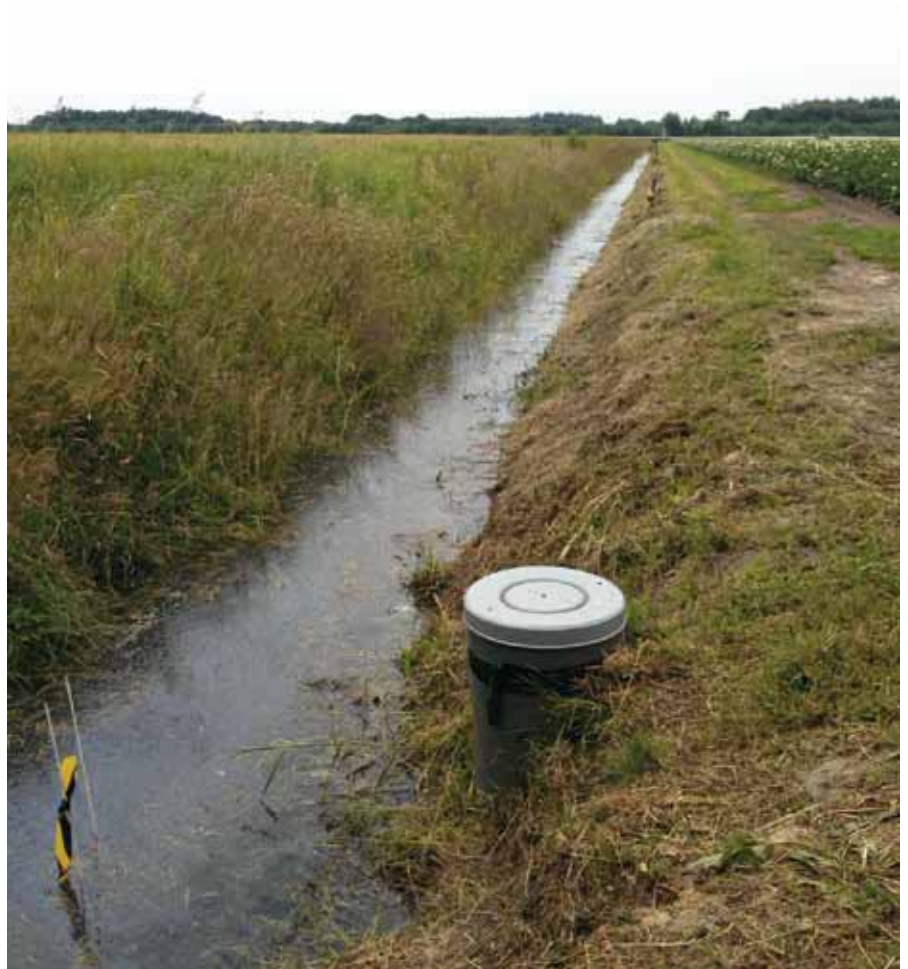
Sub-irrigatie via een klimaatadaptief drainagesysteem in Marwijksoord. Het water in de sloot dient als bron. Op de voorgrond de infiltratieput, die verbonden is met de ondergrondse verzameldrain en drainagebuizen (foto: Gé van den Eertwegh).
