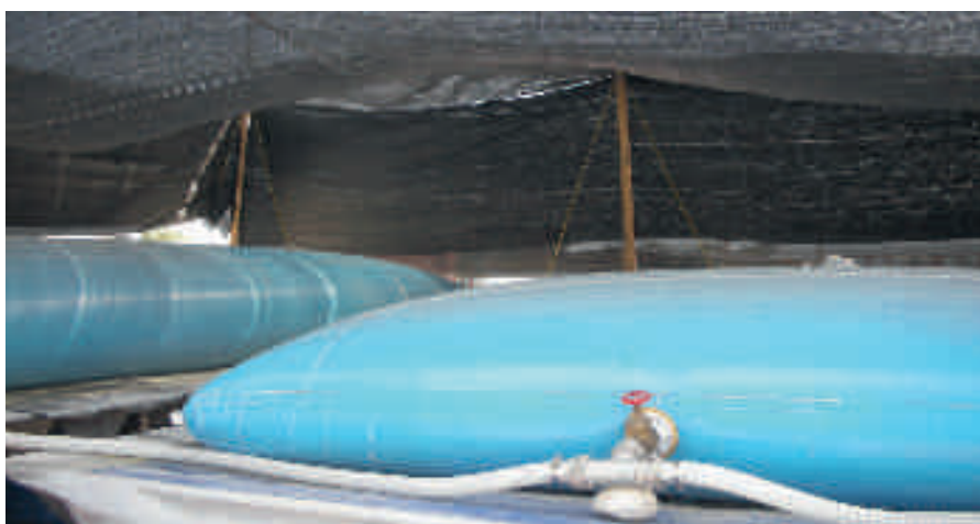
Waterzuivering in Haïti (foto: Aurelle Baumeil).
