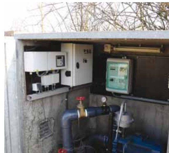
De container met controller, pompen en aansturing.
