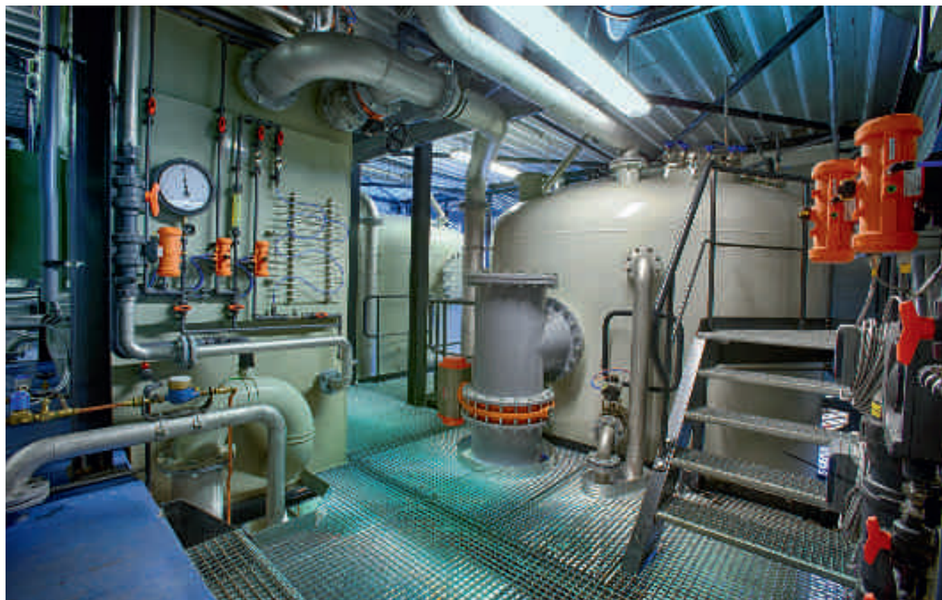
Het nieuwe drinkwaterproductiestation.
