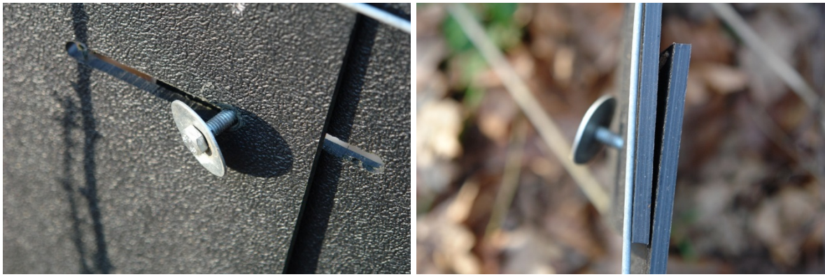
Figuur 4 Voorbeeld van de zeskant machinaal bouten die de HDPE kunststofplaten op hun plaats dienen te houden. Onder andere door weersinvloeden gaan de bouten 'werken' en ontstaat er speling met als gevolg dat de ruimte tussen de platen steeds groter wordt. Dit kan er toe leiden dat gewone padden en bruine kikkers alsnog tijdens de voorjaarsmigratie eindigen op de weg.
