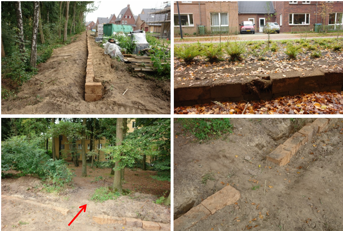
Figuur 19 Boven een deel overzicht van de permanente veenblokken muur op de grens van het Horapark en het ENKA-terrein. De foto rechtsboven geeft de 'gevoeligheid' van veenblokken weer. De onderste foto's laten één van de twee ontstane olifantspadjes (rode pijl) zien.
