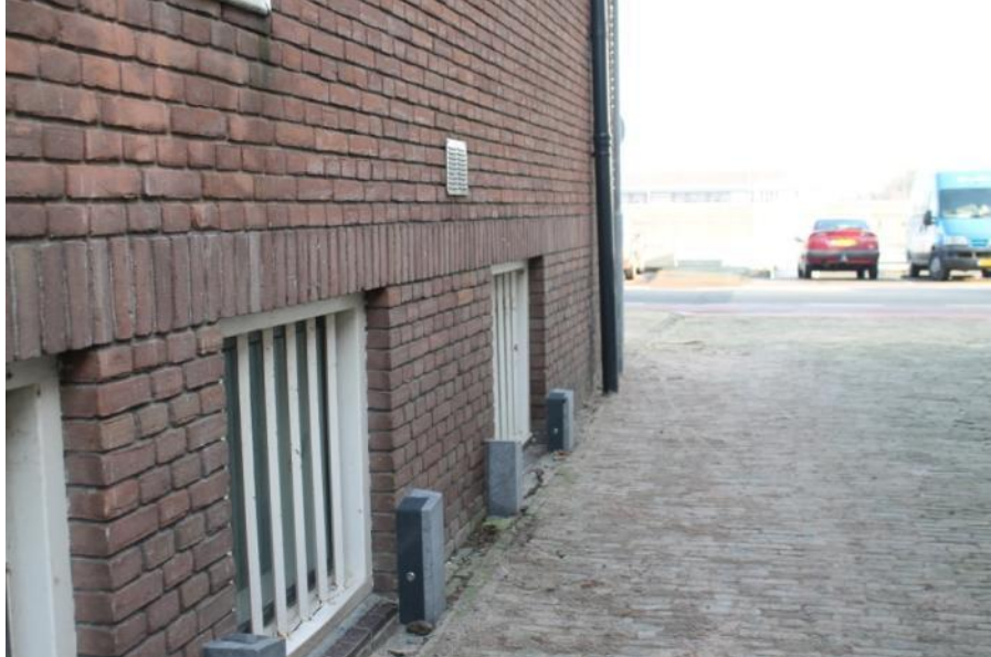
Figuur 1.4 Vloedschotten voor kelderramen in het buitendijks gebied van Kampen.
