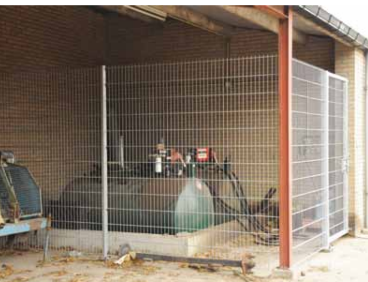
Nadat rode diesel werd afgeschaft, heeft De Bie een gaaskooi gebouwd rondom zijn tank. Hij kent de verhalen dat vrachtwagens worden leeggetankt
