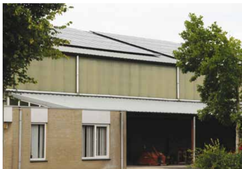
Op het dak liggen sinds twee jaar 250 zonnecollectoren met een jaarproductie van 550 kWh.
