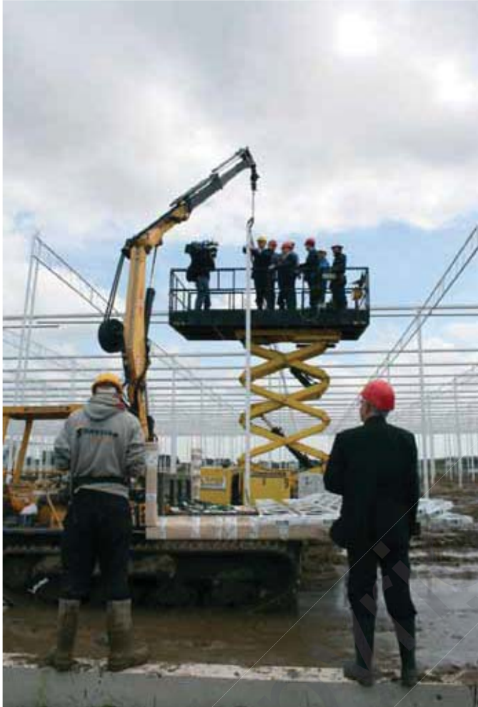
▲ Minister-president Kris Peeters stelde in juli 2012 de bouw van de serres op de site 'Stokstorm' publiek voor. (foto VILT)
