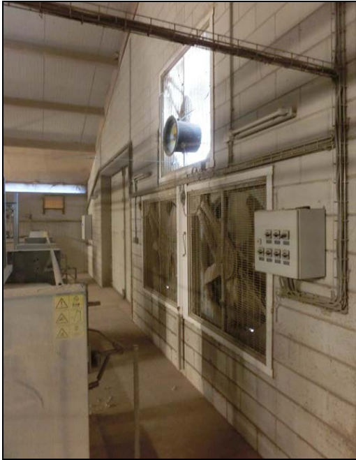
Binnenaanzicht op de eindgevel met drie ventilatoren
