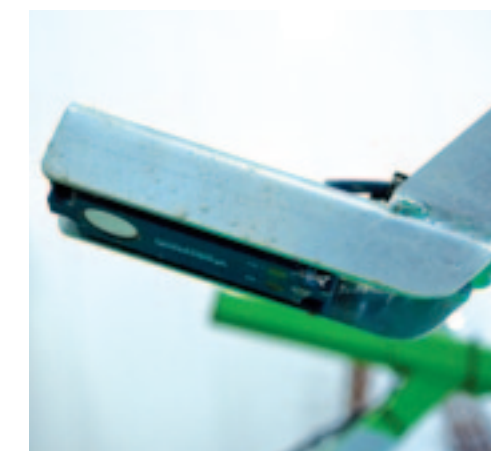
^ Sensoren Boven de bunker hangen twee sensoren die de belastingtoestand van de bunker in de gaten houden.
