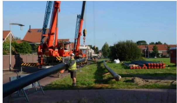
Aanleg hoofdtransportleiding van bio-energiecentrale naar het bestaande warmtenet in de wijk Kernhem.
