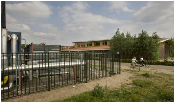
Tijdelijke gasgestookte warmtekrachtcentrale (gas-WKK) in de woonwijk Kernhem.
