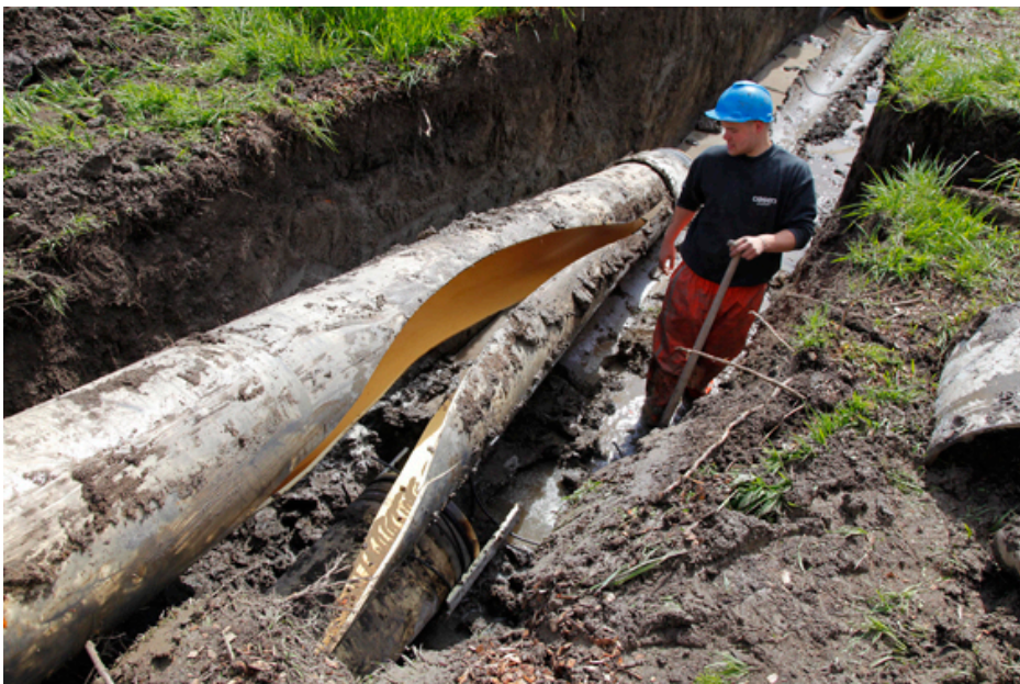
Afbeelding 1. Een waterleiding in Alphen aan den Rijn is bezweken door excessieve zettingen in de ondergrond (fotoburo Martin Droog)
