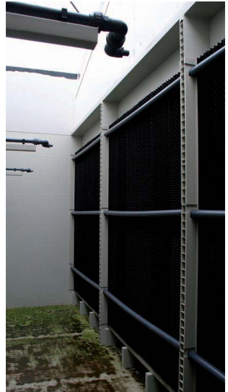
Een chemische luchtwasser zorgt voor 95 procent reductie van de ammoniakuitstoot.
