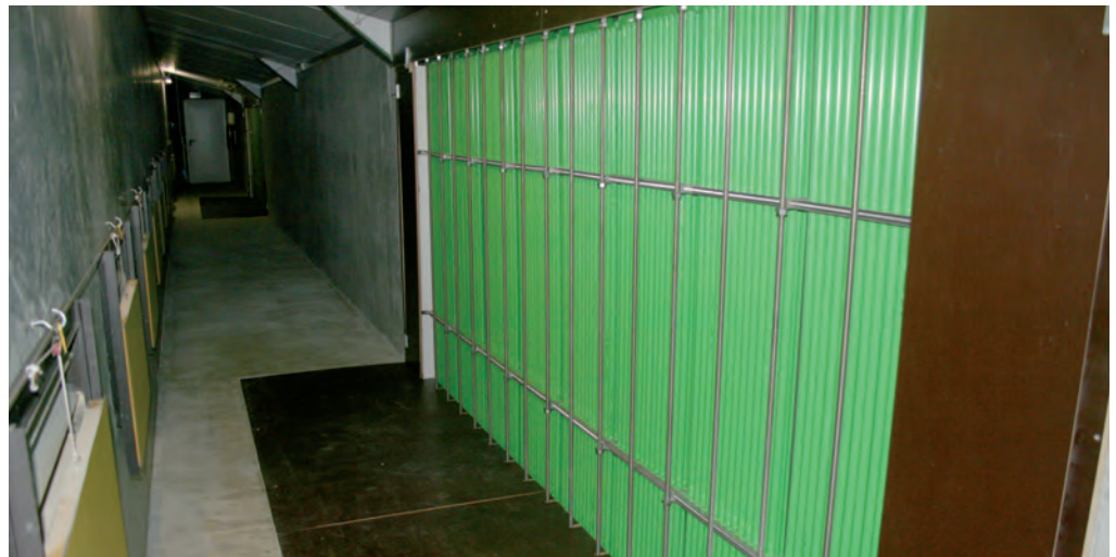
Middels een warmtewisselaar wordt de binnenkomende stallucht opgewarmd of gekoeld.
