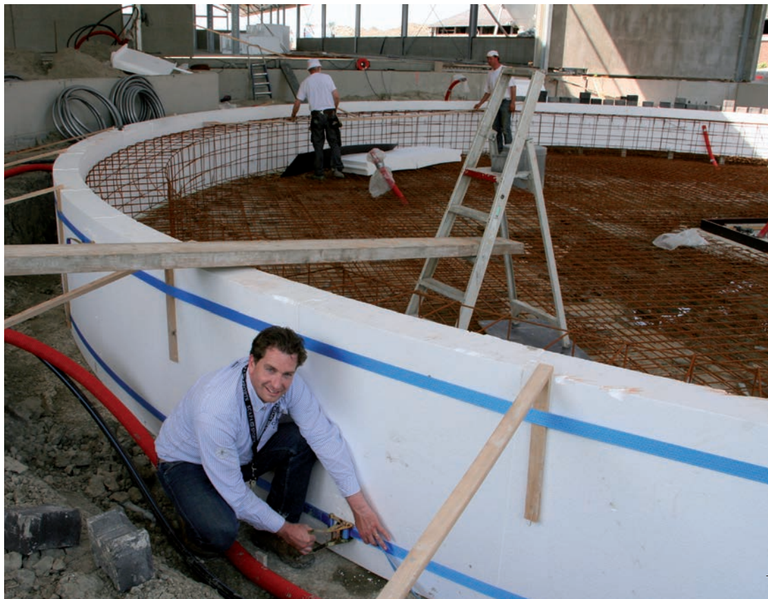
"Waar de spanbanden moeten worden bevestigd, is exact berekend", zegt Martijn van Brug.
