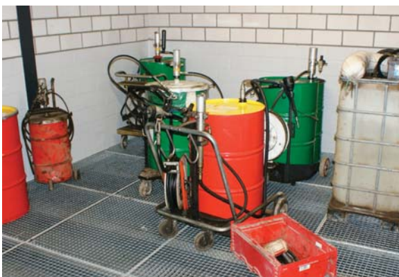
◀ De aparte olieruimte is ook nog niet af, de open vloer met ingebouwde olieopvang wel. Hier komen nog de grote vaten die worden gekoppeld aan de directe olieafzuiging vanuit de werkplaats.
