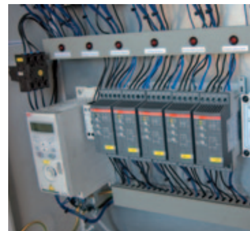
^ Storingindicatie Bij de PLC's vind je een aantal waarschuwingslampjes die een indicatie geven voor mogelijke storingsoorzaken.
