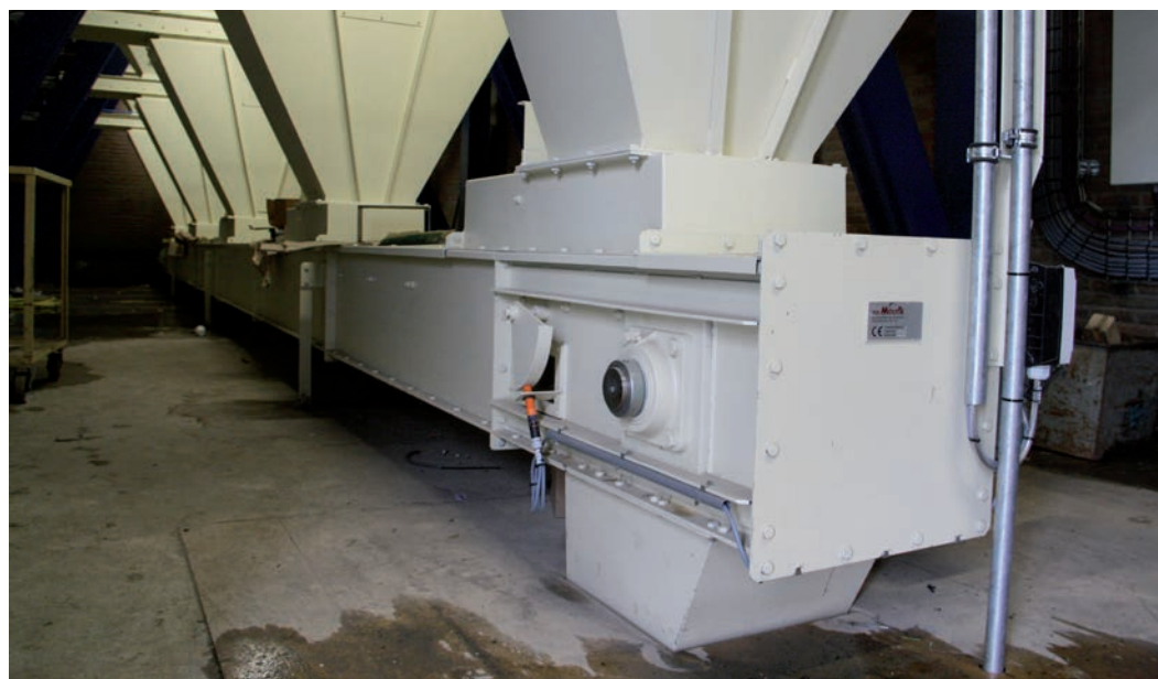
De wegende schroef bevindt zich in een kelder onder de nieuwe grondstofcellen.
