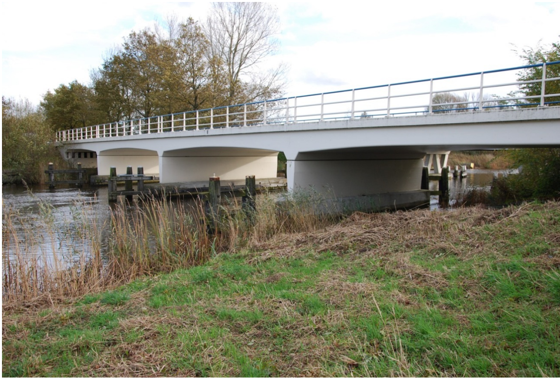
Figuur 2.5 Voorbeeld van een brug met een droge onderdoorgang, die eenvoudig passeerbaar is voor otters (N355 Rijksstraatweg kruist hier Kukhemstervaart; locatie 89, Fr); foto Loek Kuiters.
