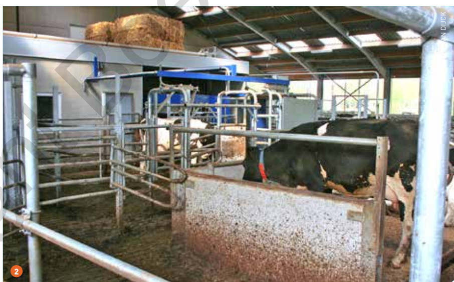
1 Van in de wachtruimte kunnen de koeien 3 kanten op gestuurd worden. Naar de robot, naar de voorste ligboxen of naar de achterste rij ligboxen (of de weide). 2 Op het einde van de boxrij zijn de keldermuren 30 cm dik als steun voor de boxplaat, de roostervloer en de eindmuur. Een slim bedacht plan.
