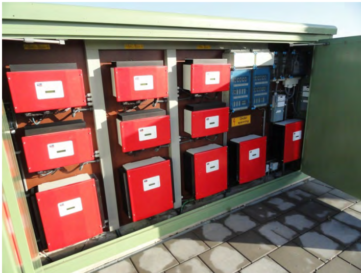
Foto 9: Kast met de SMA-inverters en bruto productiemeters
