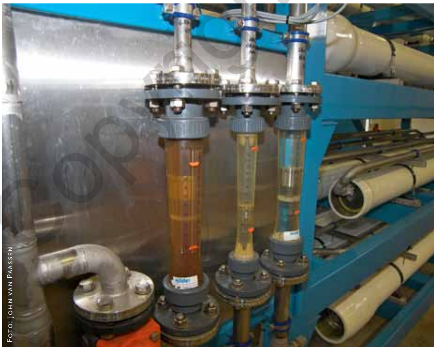
Installatie voor dubbele omgekeerde osmose bij Kumac voor de productie van mineralenconcentraten. In de linkse, middelste en rechtse kolom zie je respectievelijk het mineralenconcentraat, en filtraat uit de eerste en tweede omgekeerde osmosefiltratie.
