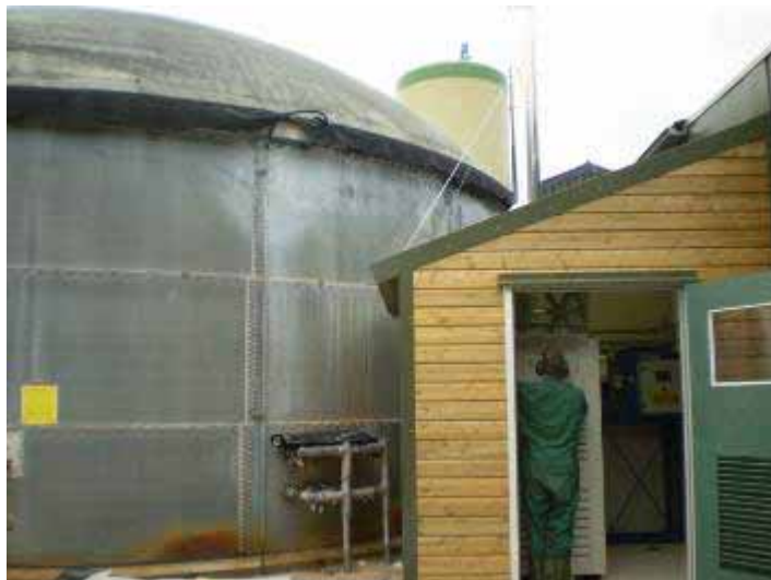
Foto 10: de mini biogasinstallatie
