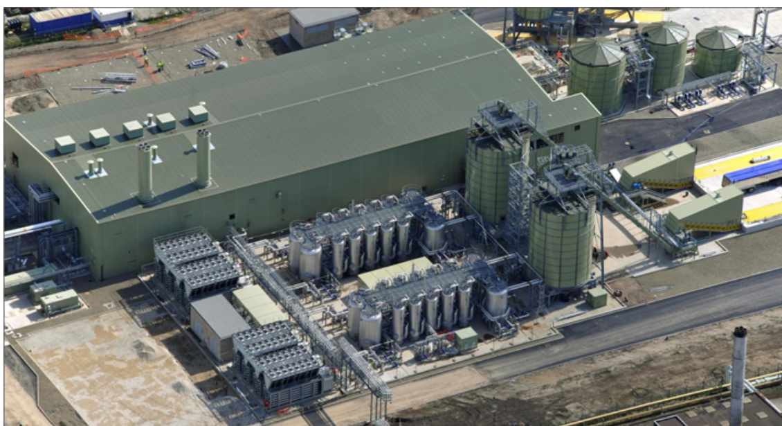
Afbeelding 2 Cambi-installatie voor thermische hydrolyse op de centrale slibverwerking Davyhulme, Manchester (capaciteit 120.000 ton ds/jaar)
