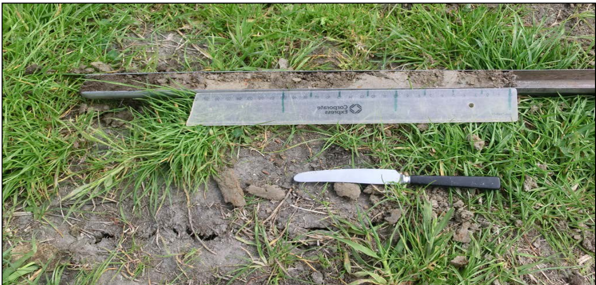
Foto 7 Bovenzijde dijk met lengtescheur en doorworteling bepaling.
