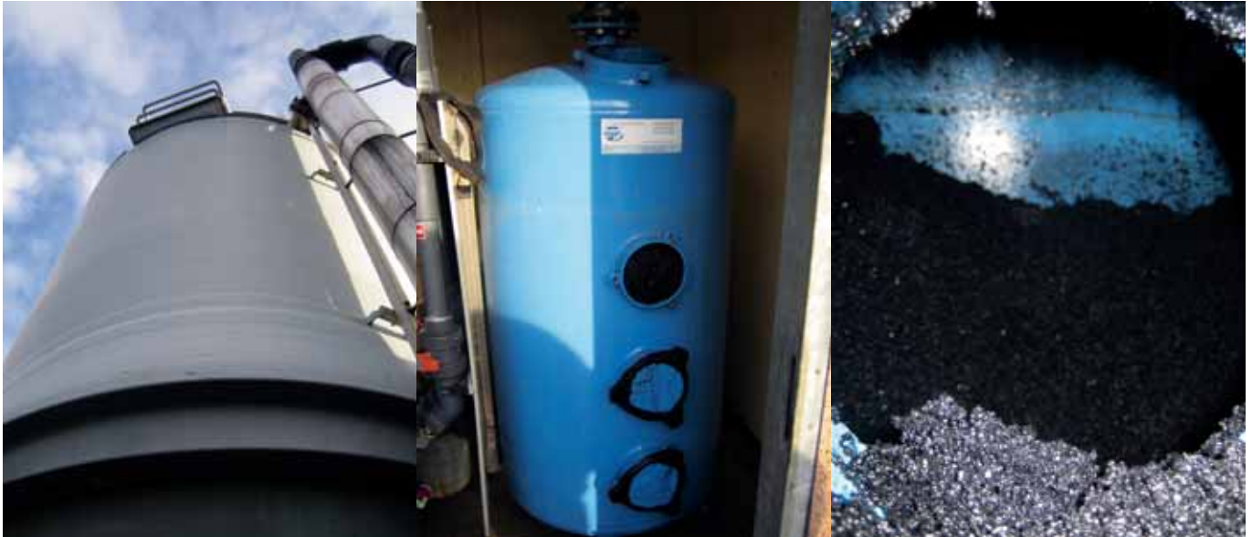
Zandfilters en actiefekoolkolom.
