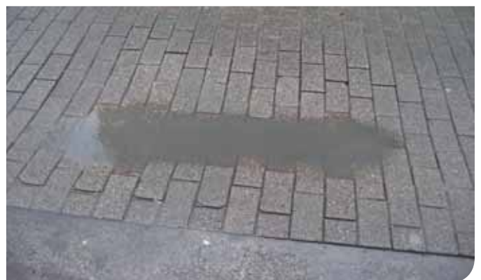
Een compromis tussen doorlatendheid en draagkracht is nodig. Hoe groter de gewenste draagkracht, hoe lager de waterdoorlatendheid.
