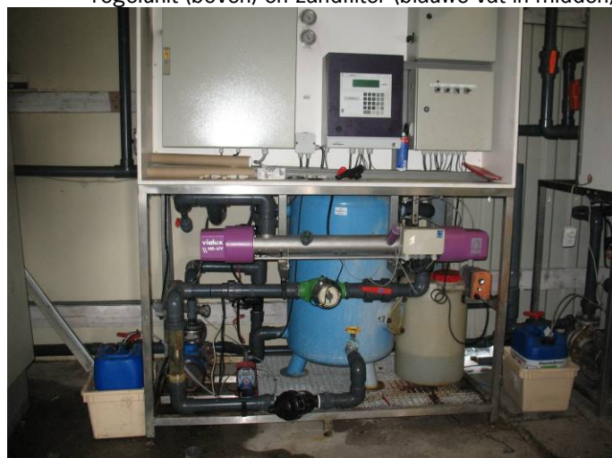
Foto 2. Installatie met hoge druk ontsmetter van Priva Vialux (horizontaal met lila uiteinden) voorzien van regelunit (boven) en zandfilter (blauwe vat in midden).
