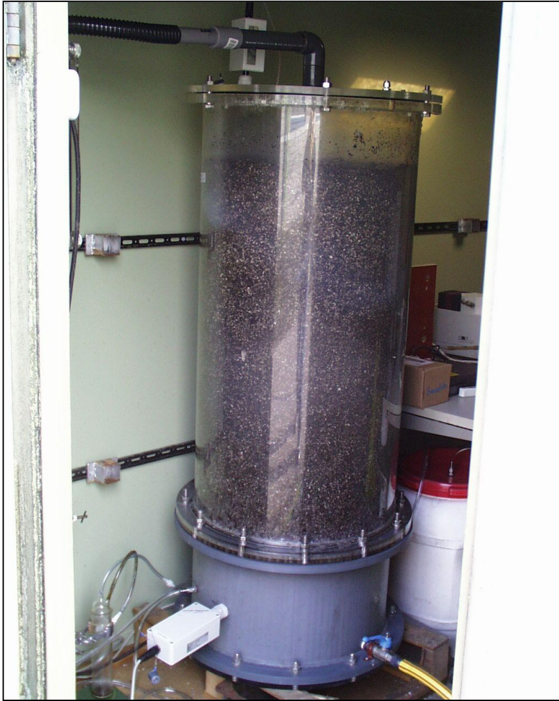
Figuur 1 Pilot-scale biofilter gevuld met compost/perliet mengsel voor methaanverwijdering uit ventilatielucht van drijfmestopslag.
