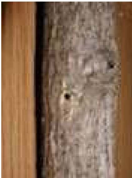
Afb. 4.: De gaatjes in de stam, zoals die kunnen worden veroorzaakt door verschillende houtaantasters.
