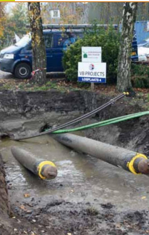
De leidingen voor het transport van warm water tussen de drie bedrijven van het cluster van 17,5 ha.
