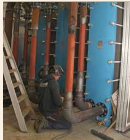
Een monteur legt de laatste hand aan de warmte-wisselaars in het pomphuis bij komkommerteler Vahl.
