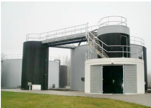
Afbeelding 2: De DEMON-installatie op de rwzi Nieuwegein.
