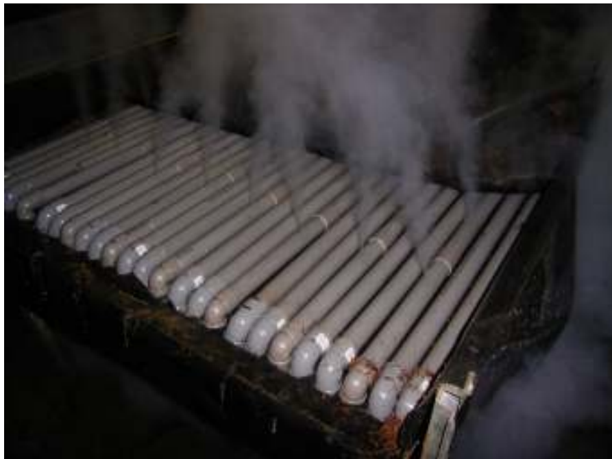
Foto 2: Beluchtingsbuizen met uitstroomopeningen
