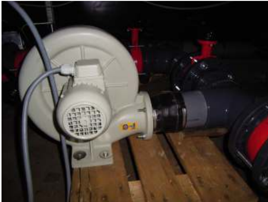
Foto 1: Ventilator met kleppen voor omschakelen luchtrichting
