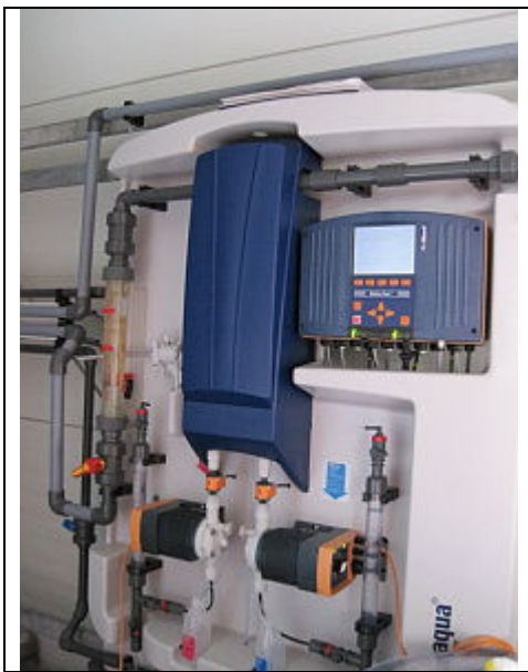
Foto 1: Generator Code A
