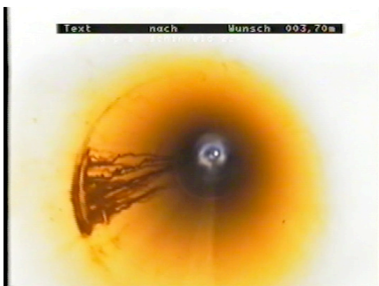
Afbeelding 3. Lekkende verbinding in een pvc-put
