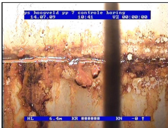
Afbeelding 5. Doorgeroeste RVS-verbinding Boven de diepe stijghoogte, maar onder de grondwaterstand
