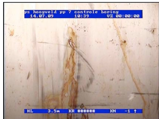
Afbeelding 6. Een RVS-buis met microbiologisch geïnduceerde corrosie
