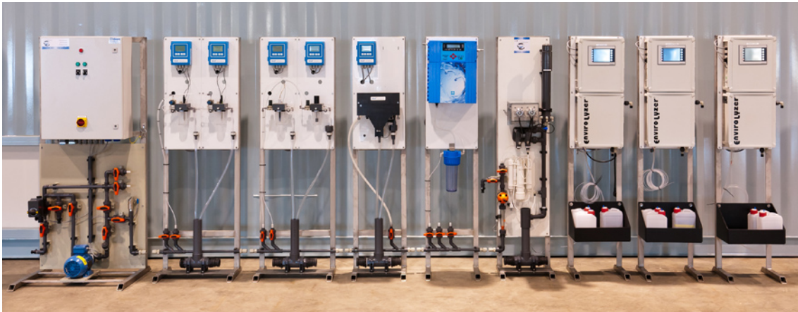
Afbeelding 1. SLIMM-box opstelling op de Vitens productielocatie Oldeholtgade in Friesland
