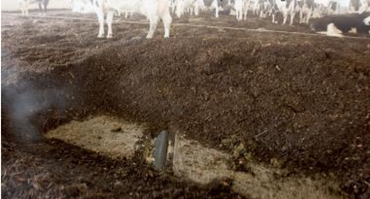
Onder de bodem van 55 cm en tussen het beton lopen de beluchtingsbuizen
