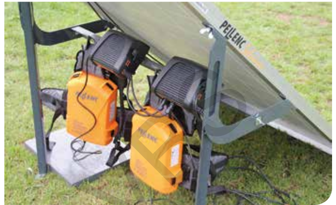
Met dit systeem kunnen tot 4 batterijen gelijktijdig geladen worden.
